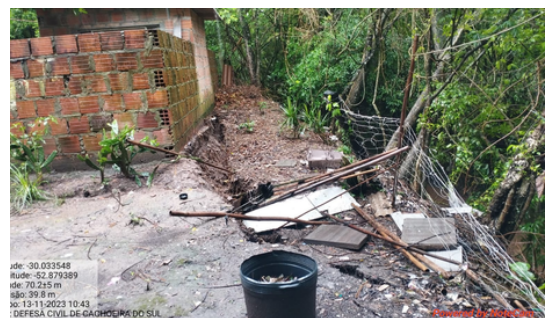
Intensidade das chuvas provocou movimentação de massa
