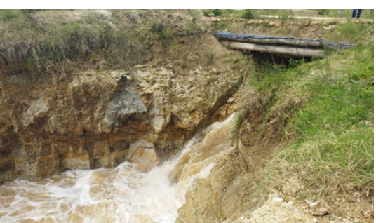
Danos em pontes e estradas vicinais
