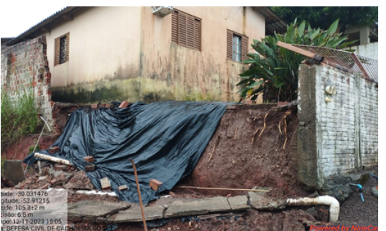
Intensidade das chuvas provocou movimentação de massa
