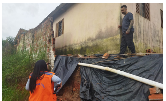
Intensidade das chuvas provocou movimentação de massa
