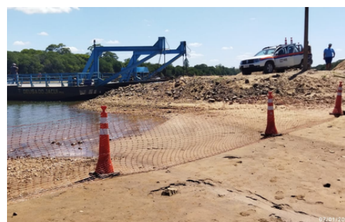
Isolamento de área de risco de acidentes.
